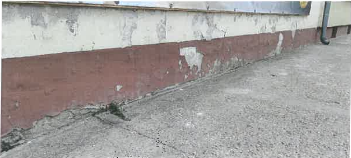
épület lábazat, lehullott vakolat
