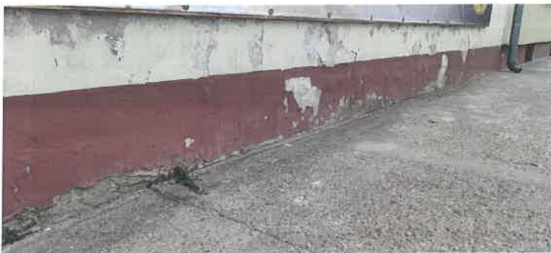
épület lábuzat, lehullott vakolat
