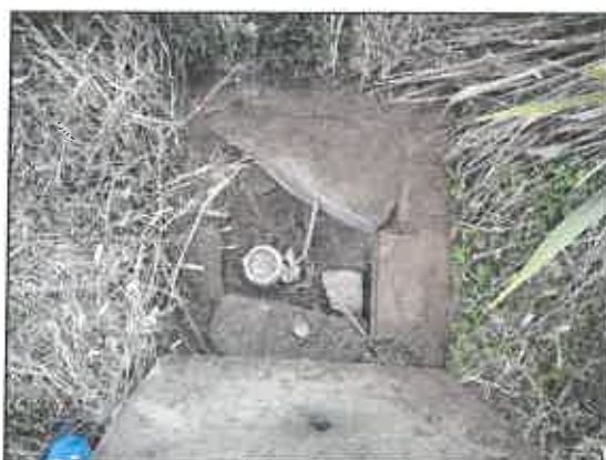
Tisztítási pont a Kikerics közben
