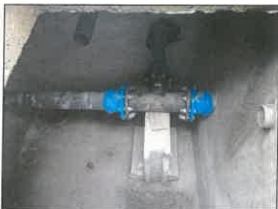
Nyomóvezetékek csatlakozási pontja
