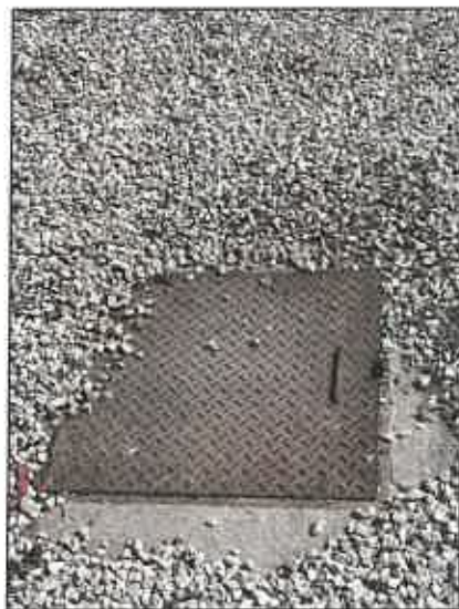
Nyomóvezetékek csatlakozási pont fedlap (Árvalányhaj utca)
